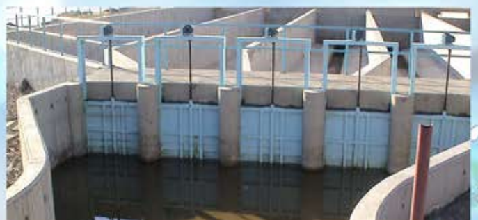
تصفیه خانه آب مشروب قم
