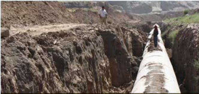
خط انتقال و محوطه سازی مخزن ۱۸۰ هزار متر مکعبی و تأسیسات برقی مخازن طرح انتقال آب طالقان به کرج
