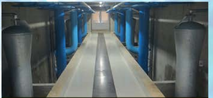
تصفیه خانه آب شرب و مخازن بتنی ذخیره آب شهرهای ایهر و خرمدره
