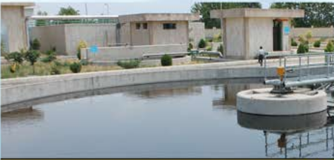
احداث تصفیه خانه فاضلاب شهر ساری
