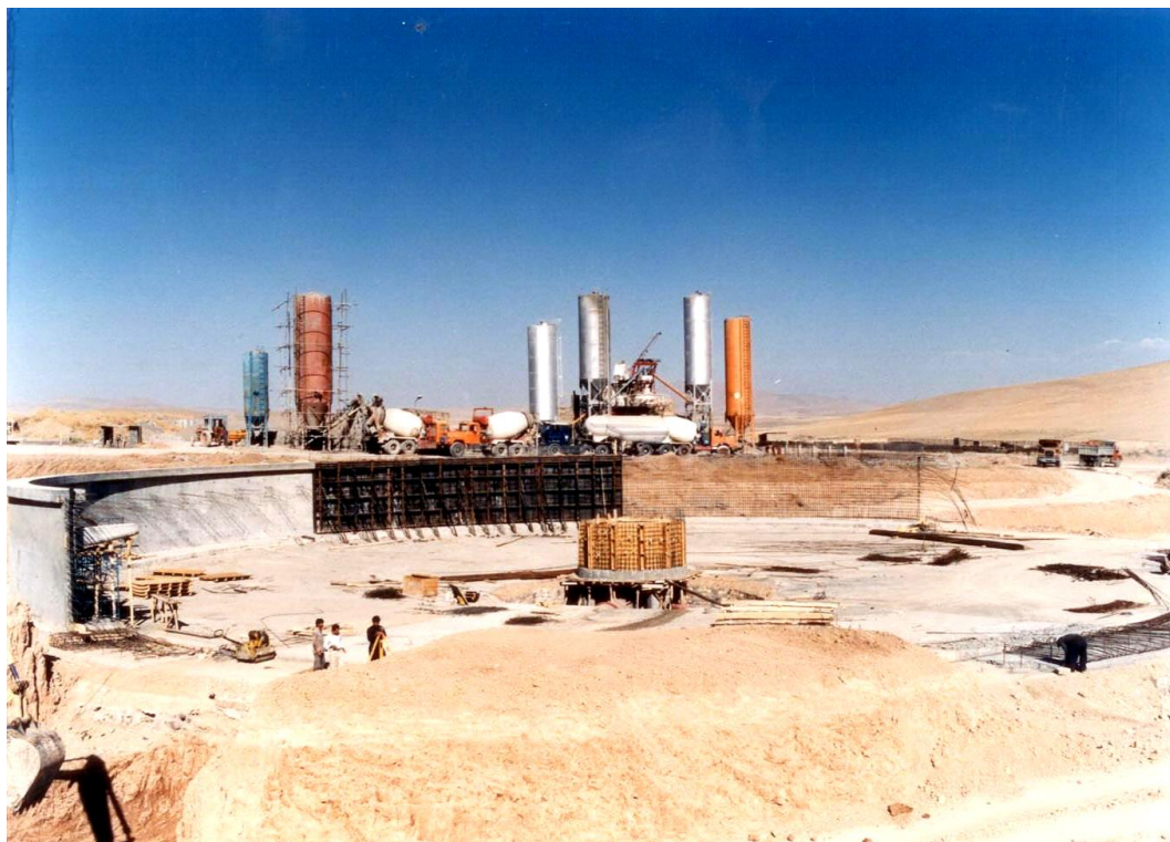
اجرای زلال سازها و سایت تهیه بتن
